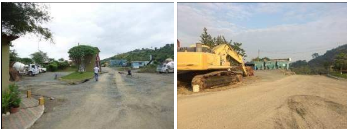
Vía de ingreso desde la garita hasta las instalaciones de la planta.
