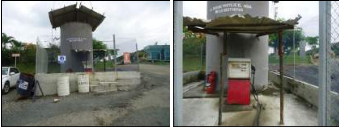
Tanque de Diesel ubicado al ingreso a la planta.
